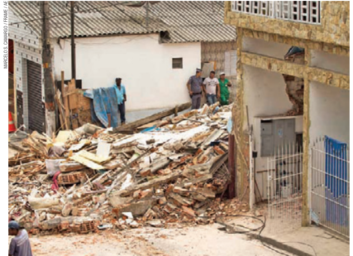
Só entulho - Retroescavadeira de obra vizinha bateu contra o imóvel, que desabou em menos de 3 minutos
