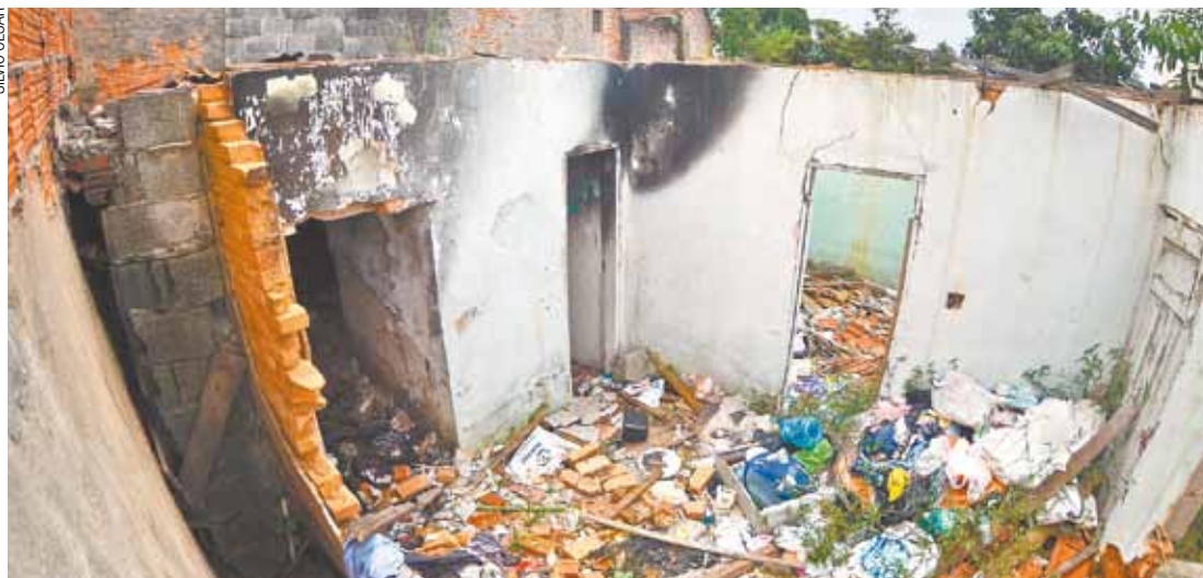
Incêndios - De acordo com vizinhos, moradores de rua atearam fogo no imóvel abandonado diversas vezes
