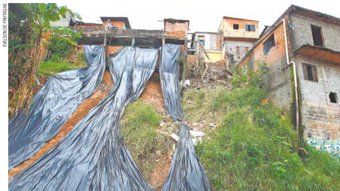
Risco - Construções em áreas de risco são monitoradas para evitar mortes em possíveis desabamentos
